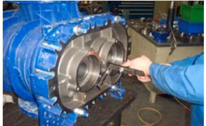
Dankzij hun jarenlange ervaring en expertise kunnen de technici van Abaris Blower Repair snel en op maat van de klant herstellen
